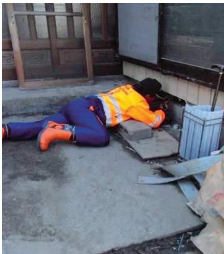
通風口から床下の泥を確認する
