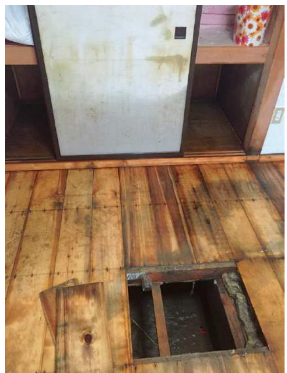
室内の被害状況も撮っておく
