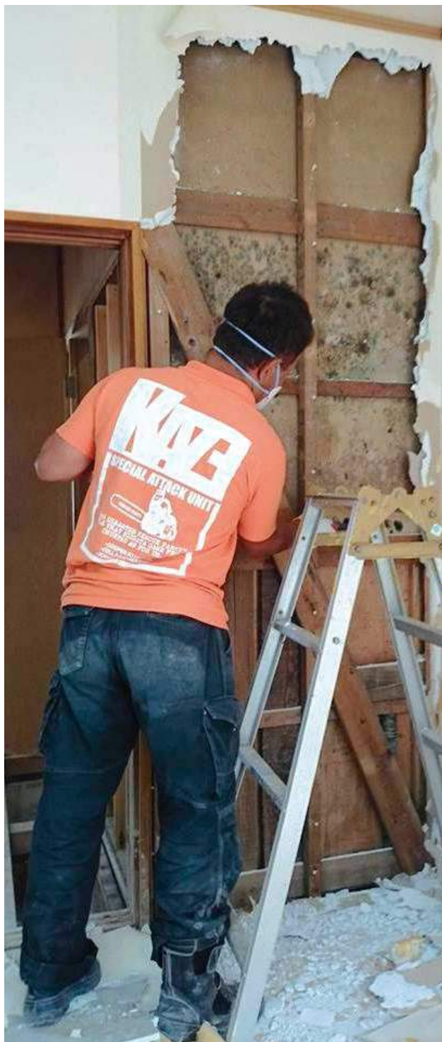
壁をはがすとカビが生えている
