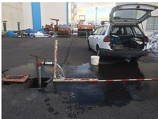
本管口径 \phi 75 の場所について 消火栓スタンドより 20cm 以下の水で使用
