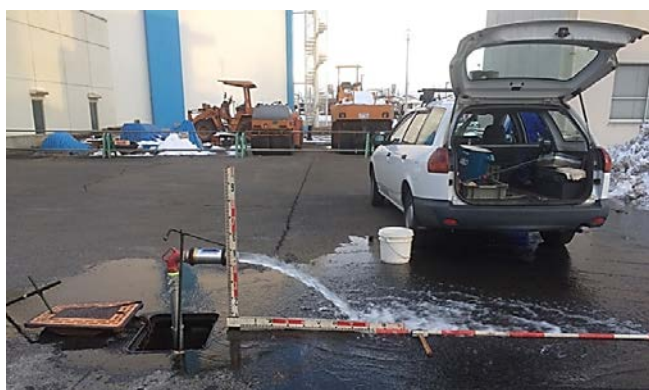
本管口径 \phi 150 の場所について 消火栓スタンドより 70cm 以下の水で使用
